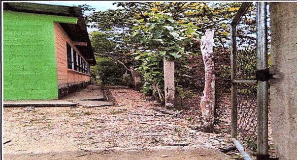
Foto 1: LOS POSTES EN MAL ESTADO Y LAS MALLAS DETERIORADAS
